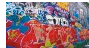
落書き被害にあった壁
