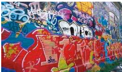
落書き被害にあった壁
