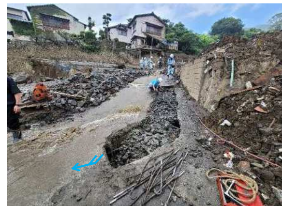
③岸谷倶楽部前の被災状況
