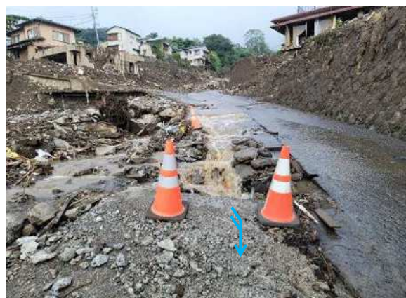
②市道的場1号線交差点下流の被災状況
