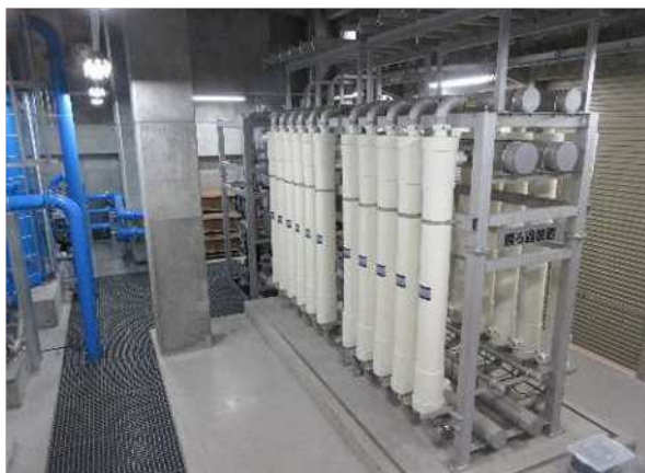
泉浄水場 膜ろ過装置
