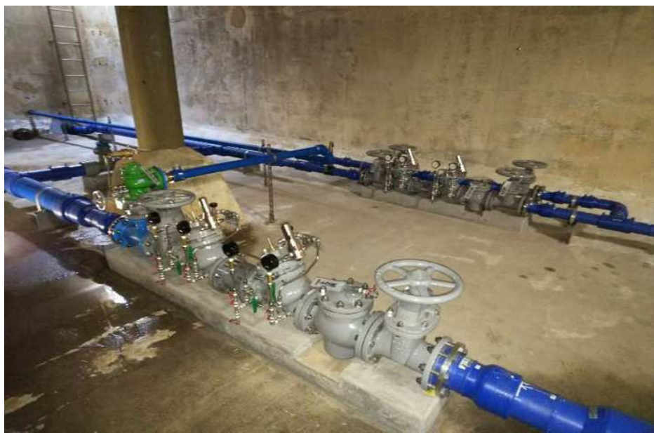
旧相の原第二配水池内 減圧弁
