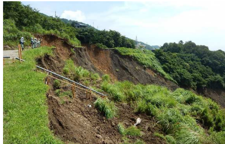
写真 令和3年7月源頭部崩壊地状況
