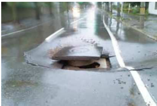
【マンホール周辺の道路陥没】
