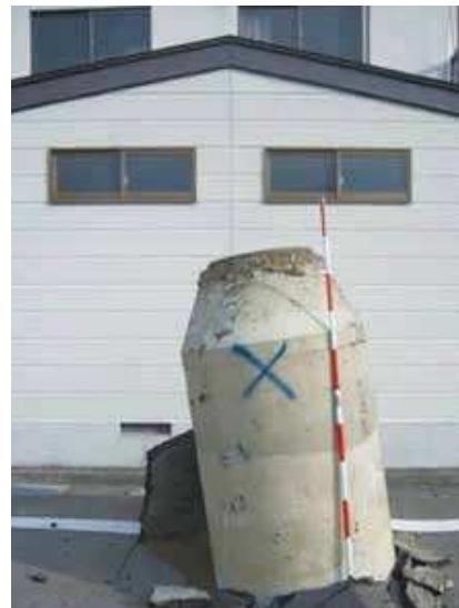
【液状化によるマンホールの隆起】
