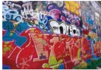
落書き被害にあった壁
