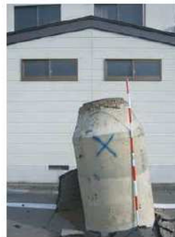
【液状化によるマンホールの歪み】
