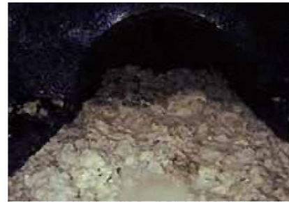
清掃前の管内（管内に油脂が溜まる）
