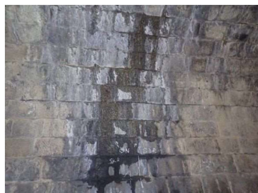
漏水状況（観魚洞トンネル）
