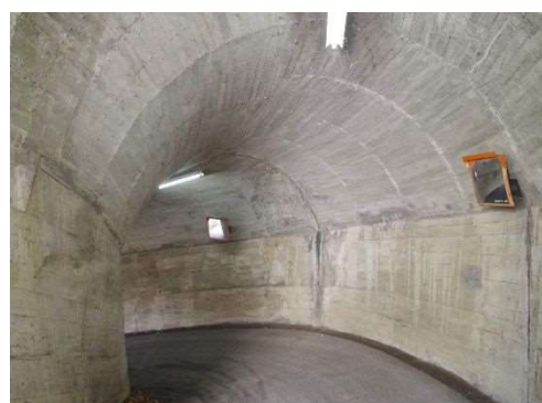
ミラー・照明施設（野中山トンネル）
