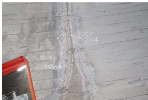
浮き・剥離状況（野中山トンネル）
