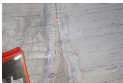
浮き・剥離状況 (野中山トンネル)
