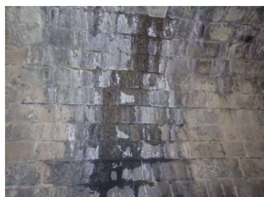
漏水状況 (観魚洞トンネル)
