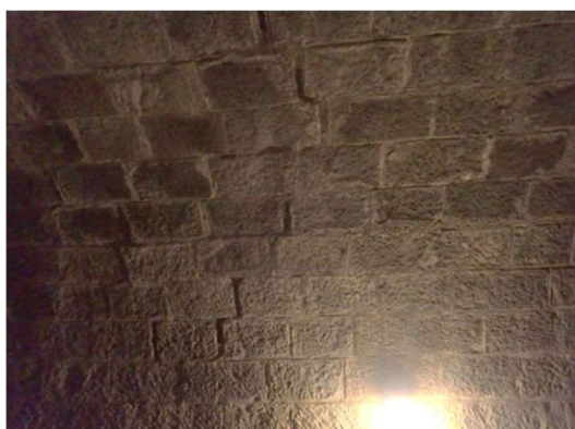
ひび割れ状況 (観魚洞トンネル)
