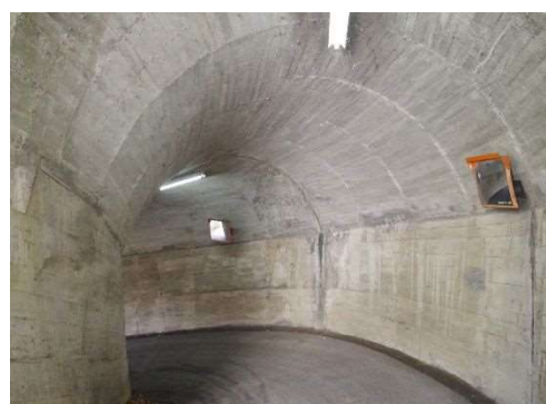
ミラー・照明施設（野中山トンネル）
