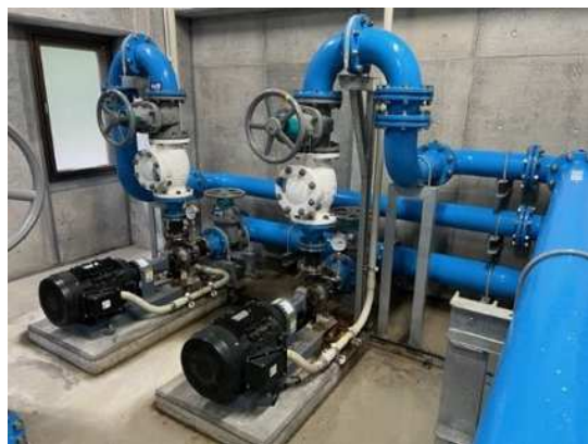
泉浄水場原水ポンプ
