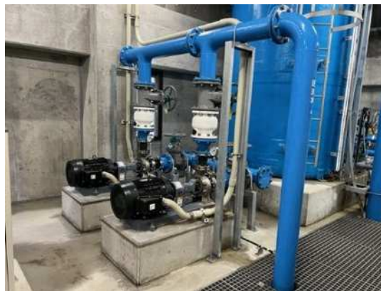
泉浄水場逆洗ポンプ
