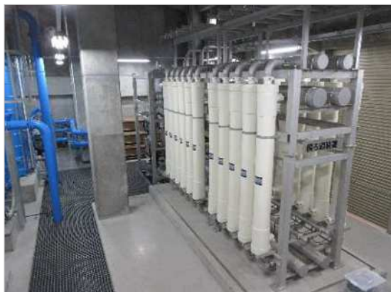
泉浄水場 膜ろ過装置
