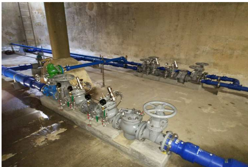
旧相の原第二配水池内 減圧弁
