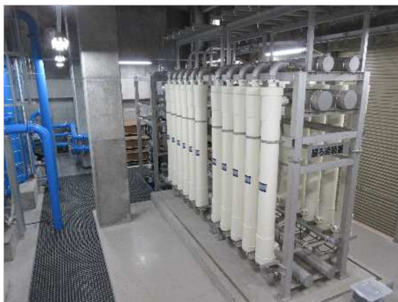
泉浄水場 膜ろ過装置
