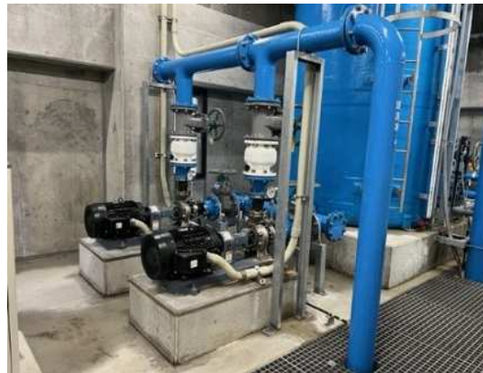
泉浄水場逆洗ポンプ
