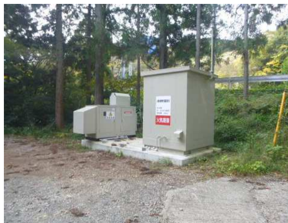
堰下ポンプ場
