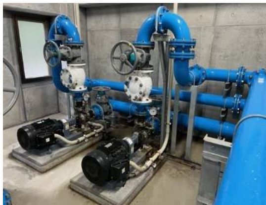
泉浄水場原水ポンプ
