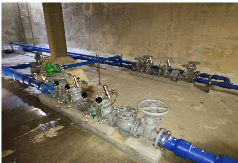
旧相の原第二配水池内 減圧弁
