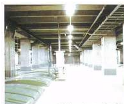
エアレーションタンク
