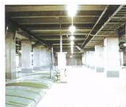
エアレーションタンク
